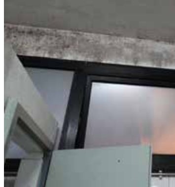
Ambienti con problemi di muffa Environments with mold problems
